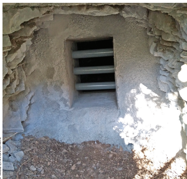
Murage de l'entrée d'une galerie avec conservation d'un accès pour les chiroptères.
